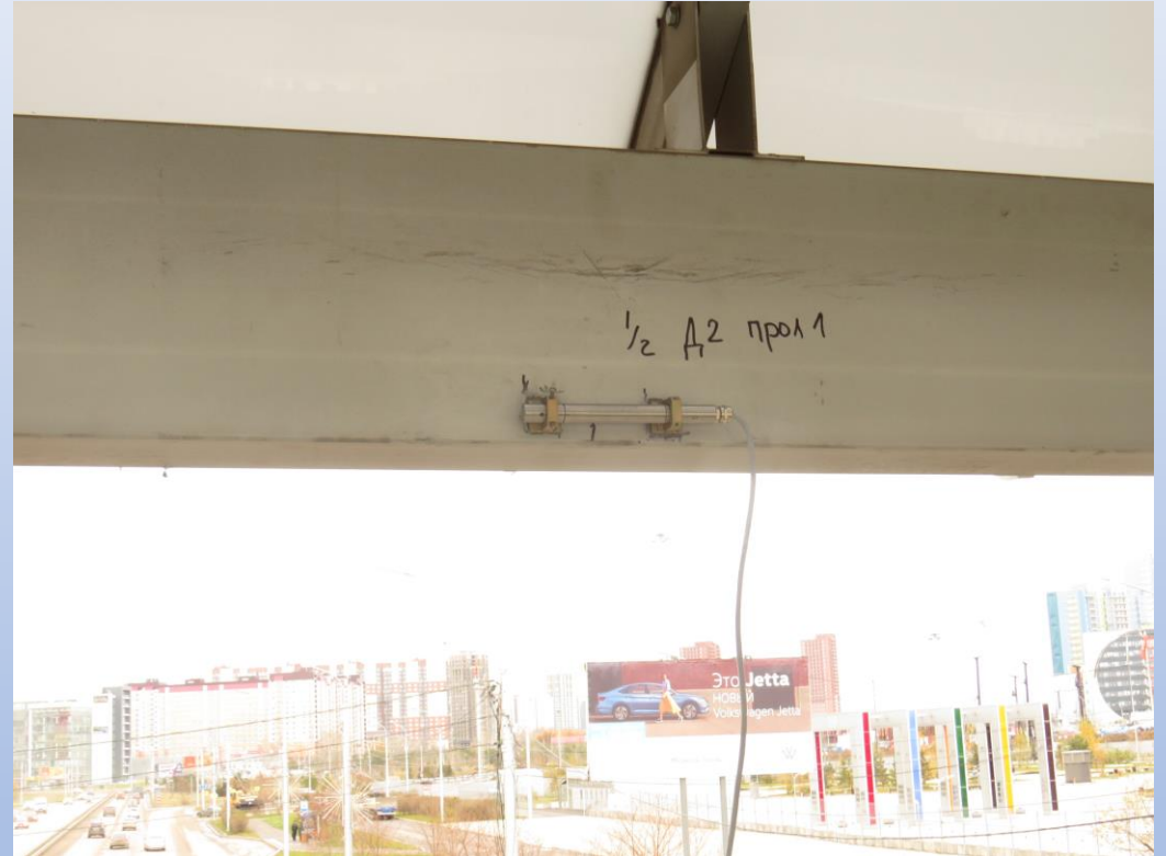
Снятие показаний с помощью струнного датчика деформаций
