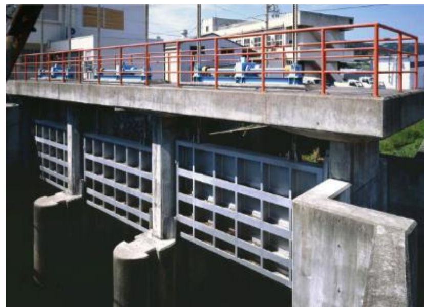
水門スライドゲート
